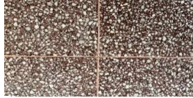
Boden Carrara Rosa und Toscana Rosa, schachbrettartig angeordnet
